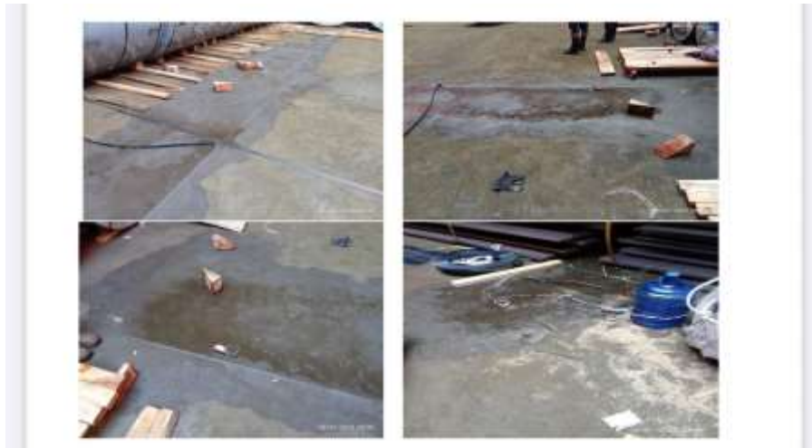
Gambar Cargo Damage lantai palka terkena air atau oli
